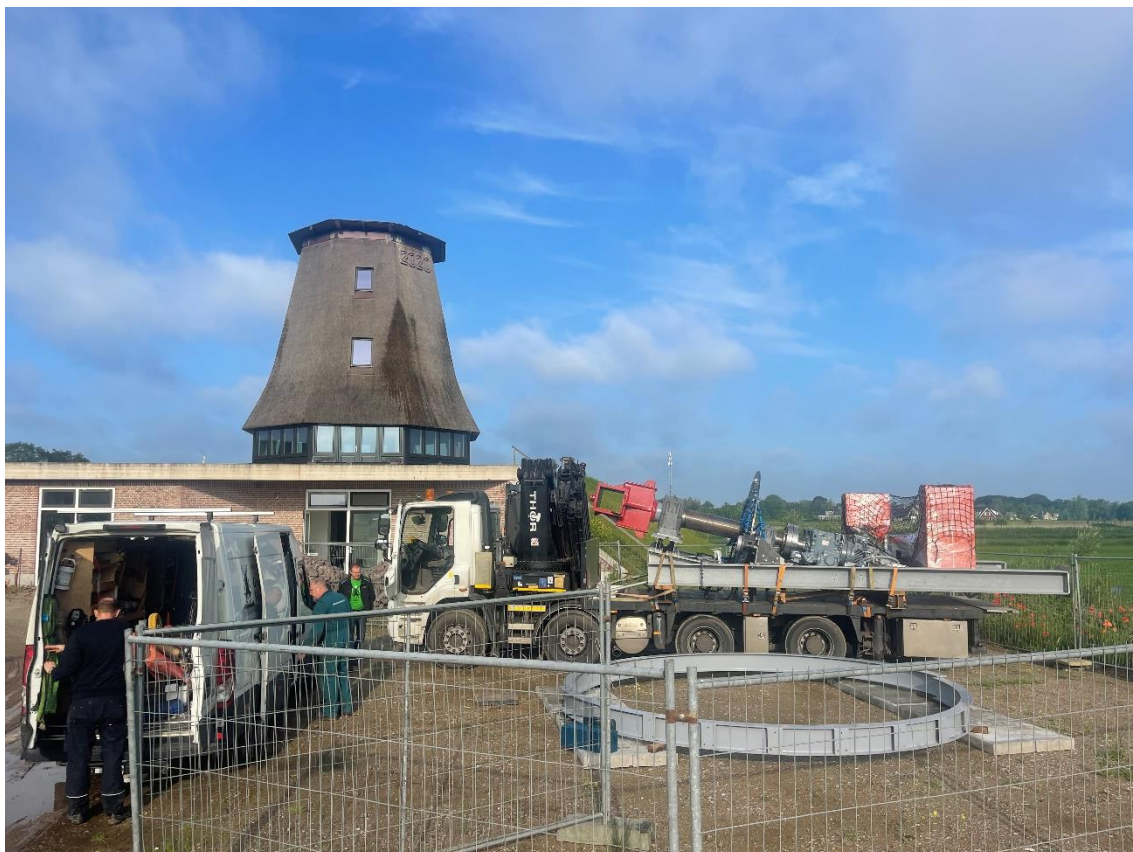
De generator wordt door Vaags Molenbouw afgeleverd bij de molen
